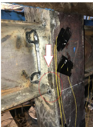
شکل ۹- نمونه قاب خمشی متوسط با جوش شیاری (IG) و ایجاد ترک در جوش ستون ناحیه چشمه اتصال پس از اعمال بارگذاری در جابجایی نسبی ۸۴ میلی متر
