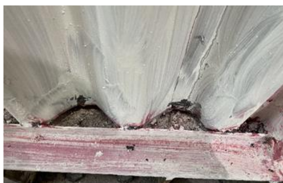
شکل ۱۸- ترک در جوش ورق موج‌دار با ورق اتصال پایین در جابجایی ۰/۴۵٪
