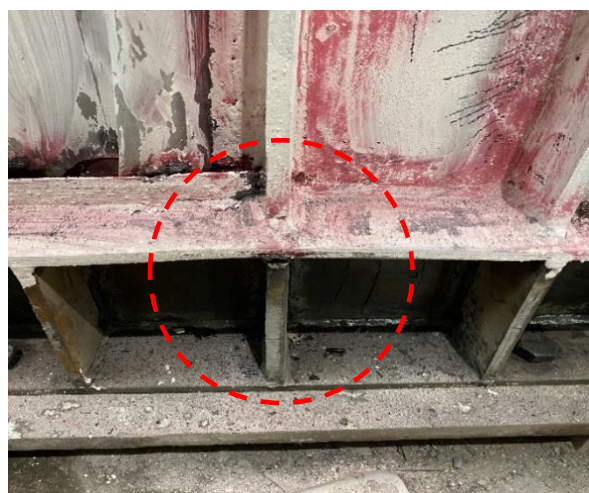
شکل ۱۶- شکست جوش سخت‌کننده زیر ستون در جابجایی ۲/۹۰٪
