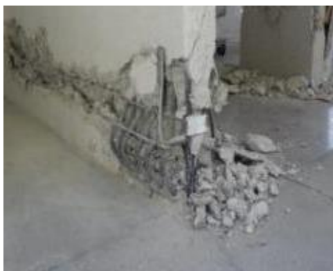
شکل ۱- خردشدگی بتن و کمانش آرماتورهای این ناحیه [۱]
